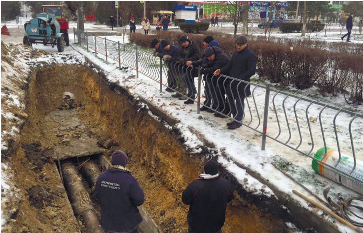
Ремонтные службы оперативно устранили аварию на магистральной теплосети в 1-м микрорайоне
